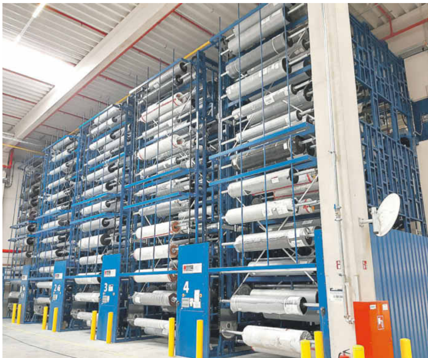
Die fünf Industrie-Paternoster im vollautomatisierten Logistikzentrallager „SkyHub“ in Hamburg
