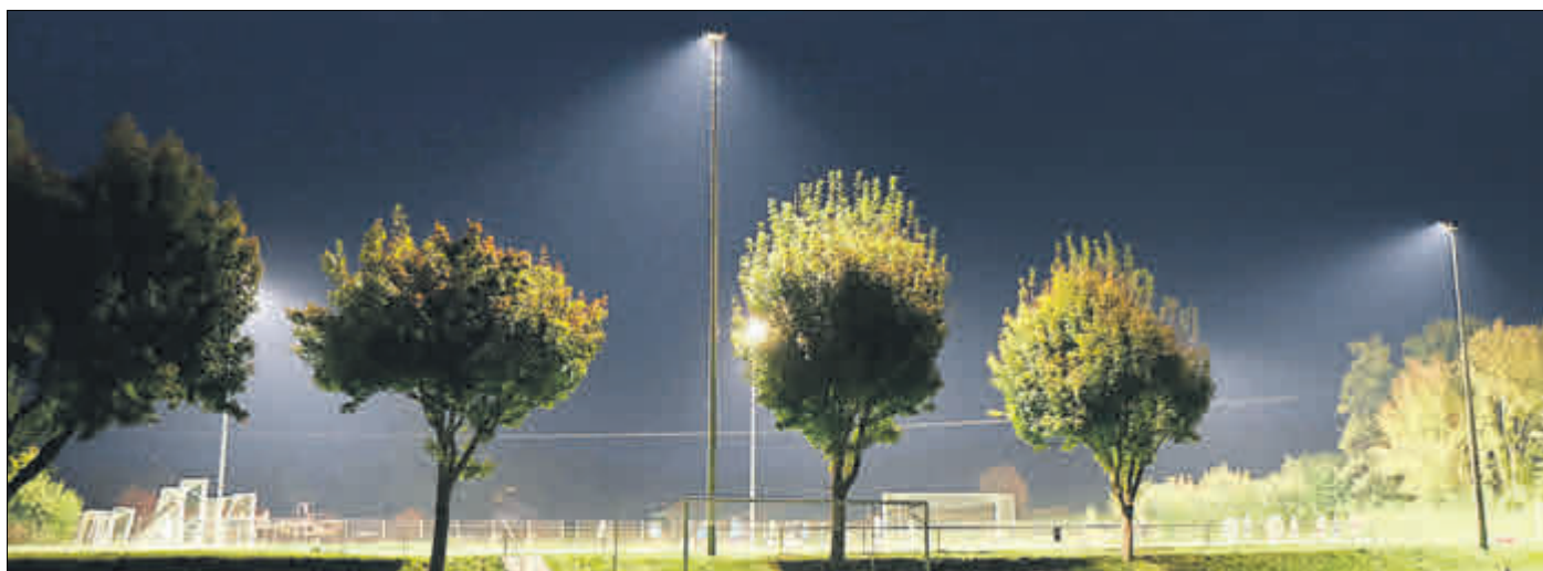
Die neue Flutlichtanlage bietet eine bessere Ausleuchtung des Platzes bei enormer Energieeinsparung.
