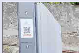
Der Aufkleber an der Ladestation markiert einen Access Point für kostenloses WLAN.
