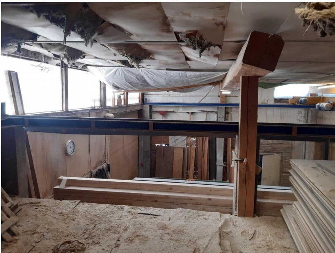
Abb. A6: Teilweise zerstörte Zwischendecken, die Wasserschäden andeuten
