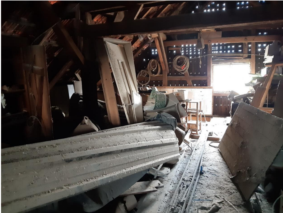
Abb. A5: Dachboden des Sägewerksgebäudes mit hoher Staubbelastung
